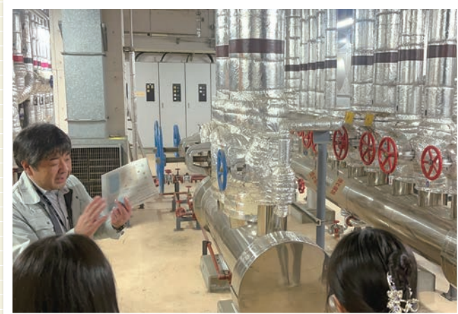
エネルギーセンターの内部は見慣れない装置がたくさん
