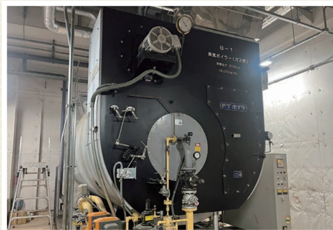
このボイラーで作った蒸気を病院へ送って暖房や滅菌などに使います
